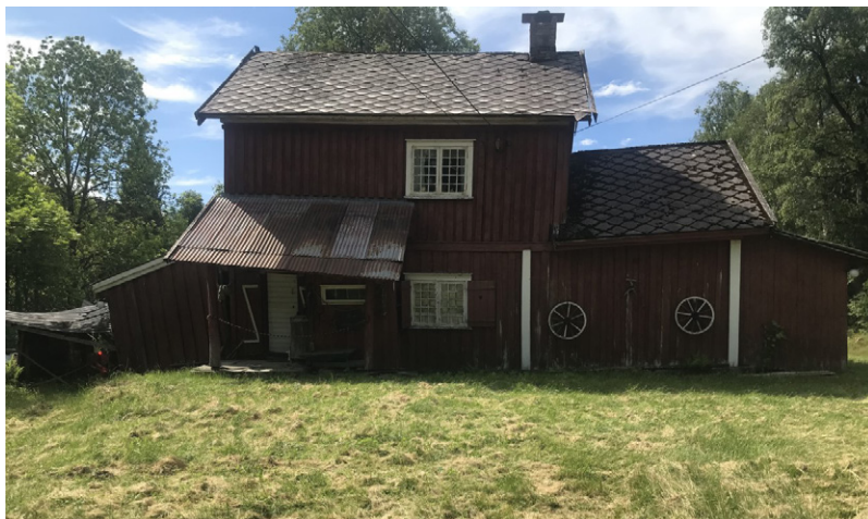
Det er ikke på grunn av huset Bakke kjøpte Hagastua. Det bærer tydelig preg av forfall etter at det har stått tomt og ikke blitt vedlikeholdt på mange år. FOTO: Stein Erik Kirkeboen.
